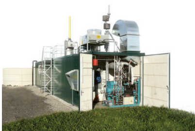
50kW-Güllewerk der Firma agricomp
